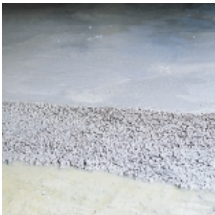
Massetto di sottofondo additivato con IDROSILEX
