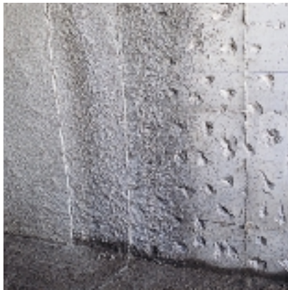
Fori di lavorazione della malta da intonaco additivata con IDROSILEX
