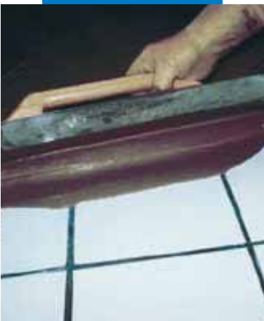
Stesura con spatola metallica di Ultraplan su pavimento esistente in ceramica previa applicazione di Mapeprim SP
